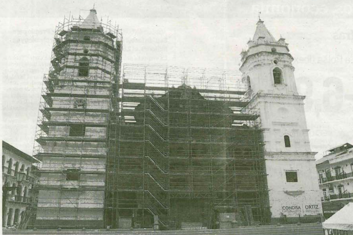
Construcciones Zubillaha ha tenido que trasladar 4.000 m 2 de andamios a Panamá desde Navarra.
